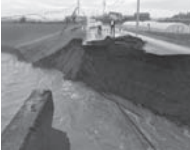
倉沼川の西5号五月橋で南側橋りよう護岸が崩落(7月5日撮影)
