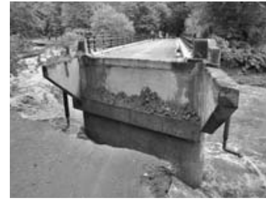
ピウケナイ川の増水で旭岳源水公園の水汲み場と駐車場につながる連絡橋・ピウケナイ橋の取り付け部が崩落(23日午前11時半)
