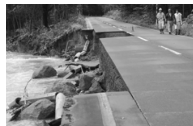
道路の一部が決壊した道道天人峡美瑛線(21日午前7時20分)
