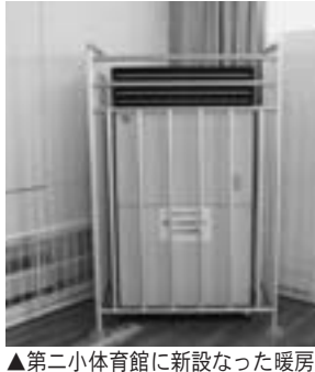
▲第二小体育館に新設された暖房機
