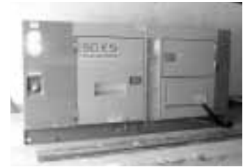
防災用発電設備
